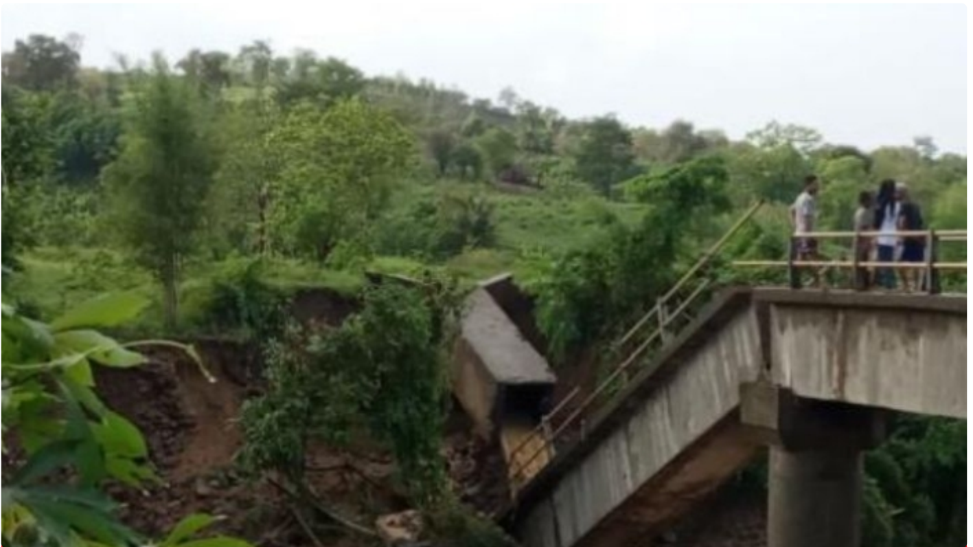
Jembatan Roboh akibat Banjir Bandeng di Lunyuk, Sumbawa, (09/10)
